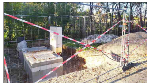
Nouvelle pompe de relevage parking de la Lune
